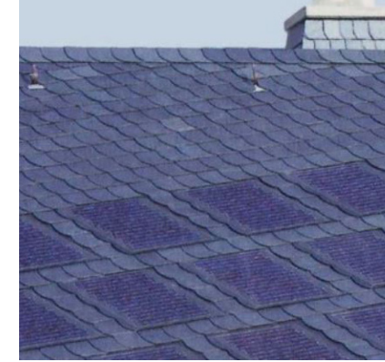
Multikristalline Solarmodule auf einem Schieferdach
